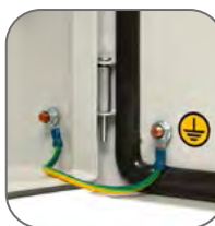
Обмедненные шпильки заземления. Закрепленный поводок заземления
