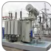
Объекты энергетической отрасли
