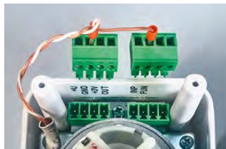
Фото 23. Подключение проводного выключателя
