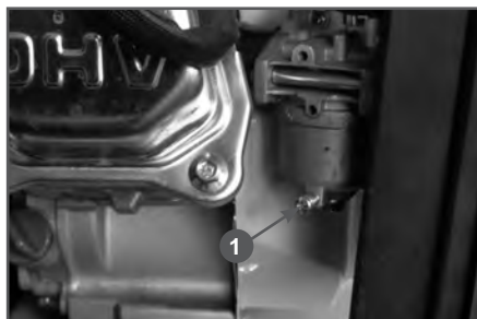
Рис. 24 Обслуживание фильтра-отстойника PC5332F
